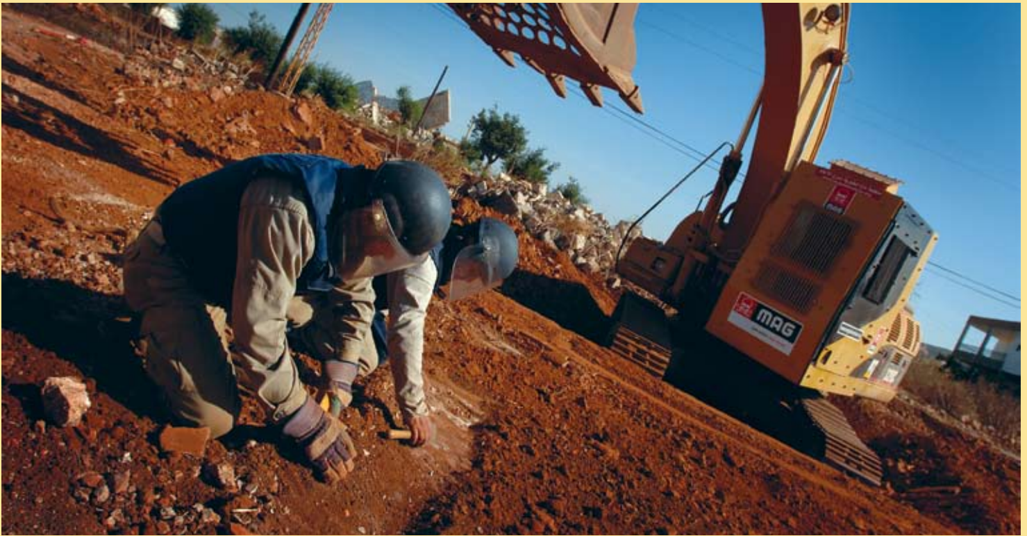
Un excavateur blindé équipé d'un godet cribleur spécialement conçu par MAG est utilisé pour chercher dans les ruines de maisons, ce qui permettra aux populations de reconstruire en toute sécurité.
