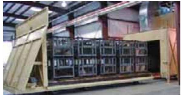
Figure 4.5 : L'installation de décontamination par flux de gaz chaud. L'automotrice est chargée avec des paniers métalliques contenant des munitions prétraitées.
