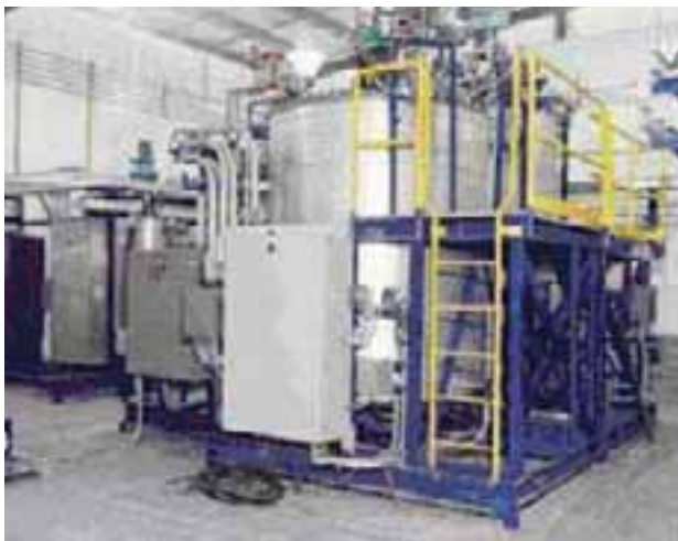
Figure 7.2 : Installation de dégradation biologique
